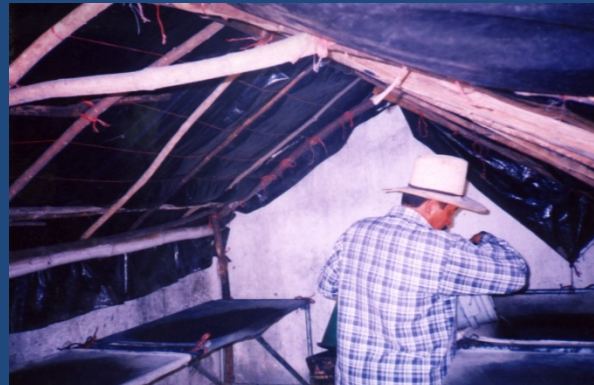
Filtración en tendales
